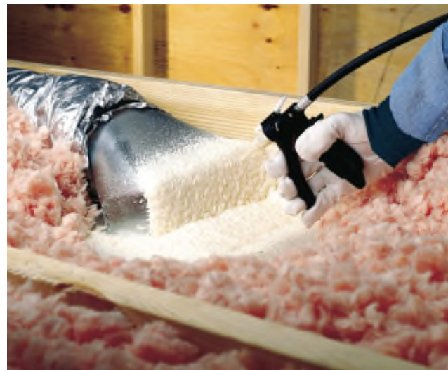
Canalisation de grenier
